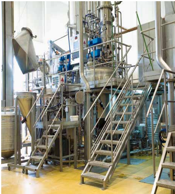
Pasteuranlage | Pasteurisation plant
